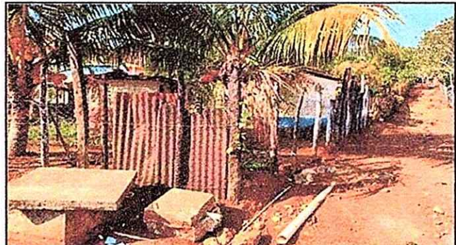
Foto 4: Mantemiento por mal estado de la malla
