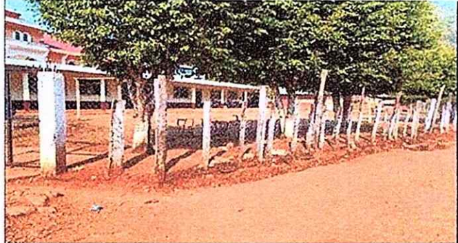
Foto 2: Mantenimiento por deterioro de los postes
